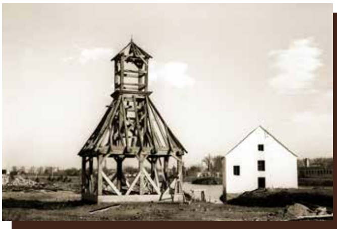
▲ Keller des Petőmihályfa-Presshauses während des Abbruchs - vorne Birkenhecken-Konstruktion, hinten Kiefer und Schleusenwand-Konstruktion Bild von: Endre Nagy (1997)
